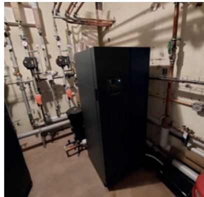
Chaufferie de la salle des Noues : changement de la chaudière et mise aux normes du réseau d'eau chaude.
